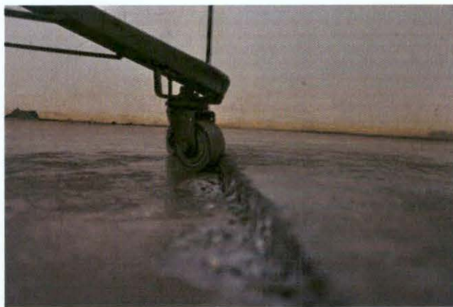
Imagem 50: Rachadura na Linear Foto: Marcelo Christovão, MPF/MS
